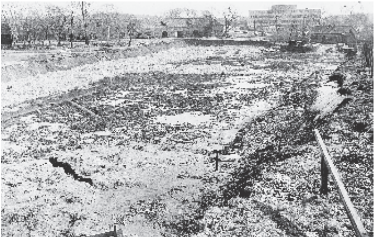
34. Platsen där radiohuset skulle byggas under schaktningsarbetet. I bakgrunden syns amerikanska ambassaden till höger och Stora Sten-skjulet till vänster.
